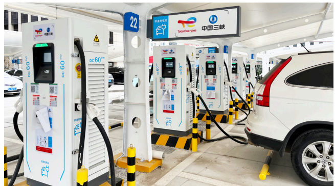
Changxia Expressway(TotalEnergies & Three Gorges Corporation) 공공 충전소 모빌리티 허브
